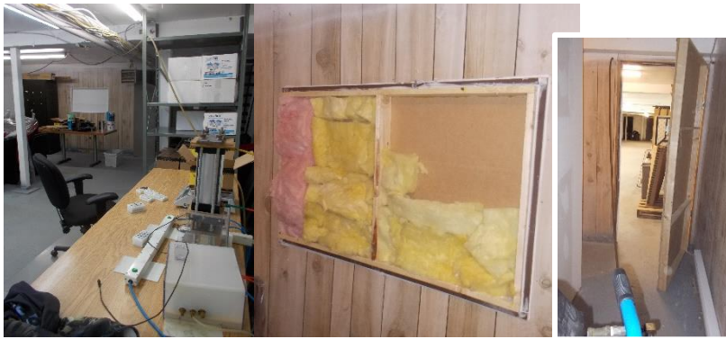
Insonorisation de la salle du compresseur (sous-sol).
